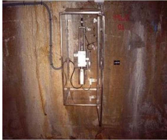
Figura 7.3. Extensómetro de hilos instalado en una presa de contrafuertes (cortesía de Iberdrola)
