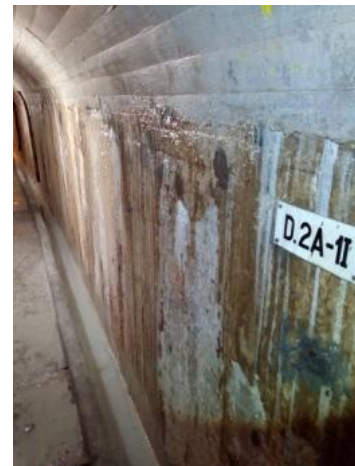
Figura 4.18. Fisura en el hastial de aguas arriba de una galería (cortesía de Iberdrola)
