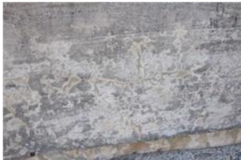
Figura 4.13. Presencia de colonizaciones en un murete de coronación (cortesía de Iberdrola)
