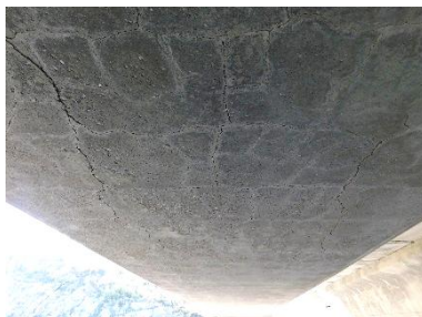
(p) Puente con corrosión 2019
