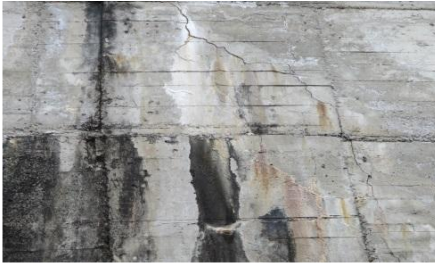
Figura 4.2. Fisuración ramificada en el paramento de aguas abajo (cortesía de Iberdrola)
