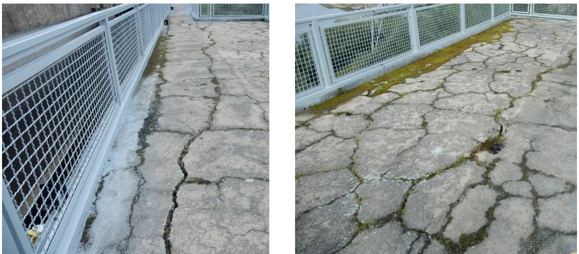
Figuras 4.38 y 4.39. Fisuración en estructuras anejas (cortesía de Iberdrola)
