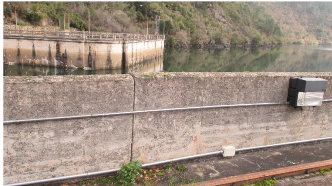
Figura 4.26. Desalineaciones en la barandilla de coronación (cortesía de Iberdrola)
