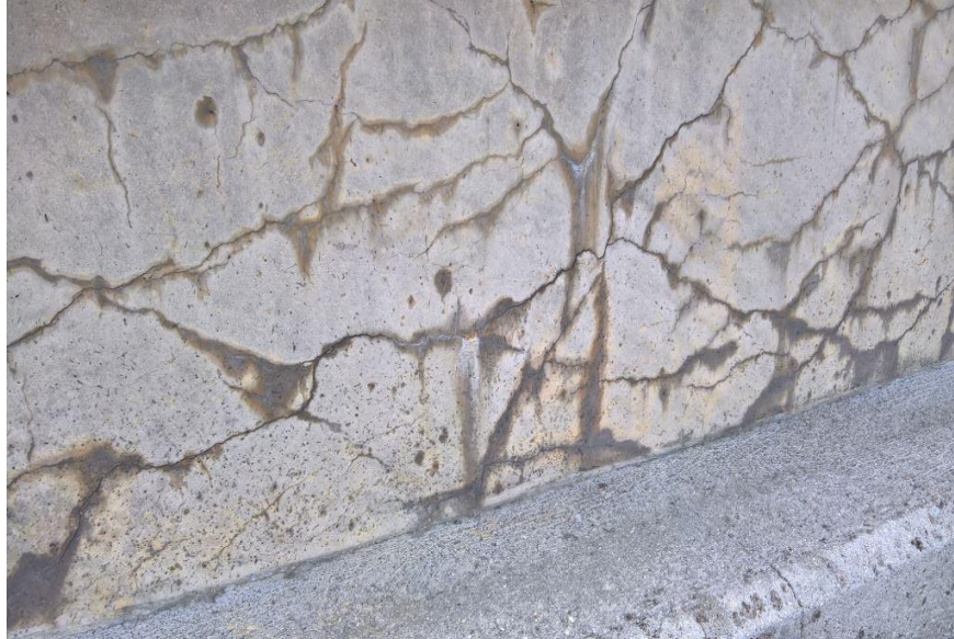
Figura 4.8. Exudación de geles en superficie de hormigón carbonatado (cortesía E. Menéndez)
