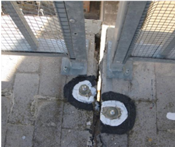
Figura 4.21. Desalineación entre bloques en coronación (cortesía IETcc)
