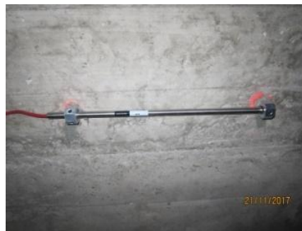
Figura 7.19. Medidor de microdeformaciones instalado en paramento de galería (cortesía de Iberdrola)
