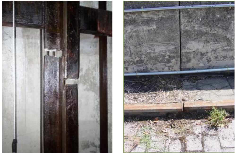
Figuras 4.29 y 4.30. Rotura de las guías de un ascensor de presa y de un carril de un puente grúa en coronación (cortesía de Iberdrola)
