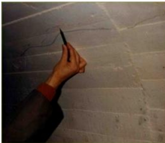
Figura 4.17. Fisura en el hastial de aguas abajo de una galería (cortesía de Iberdrola)
