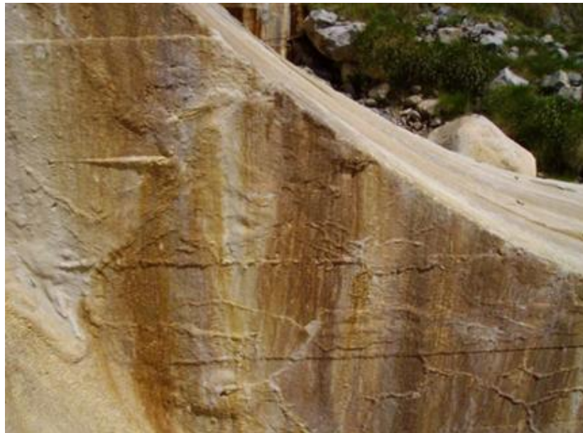
Figura 4.5. Fisuración ramificada con productos de AIS y depósitos de carbonato cálcico colmatando las fisuras (cortesía UPC)
