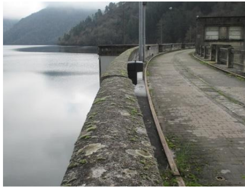
Figura 4.25. Desalineación en pretil de coronación con rotura del raíl (cortesía de Iberdrola)
