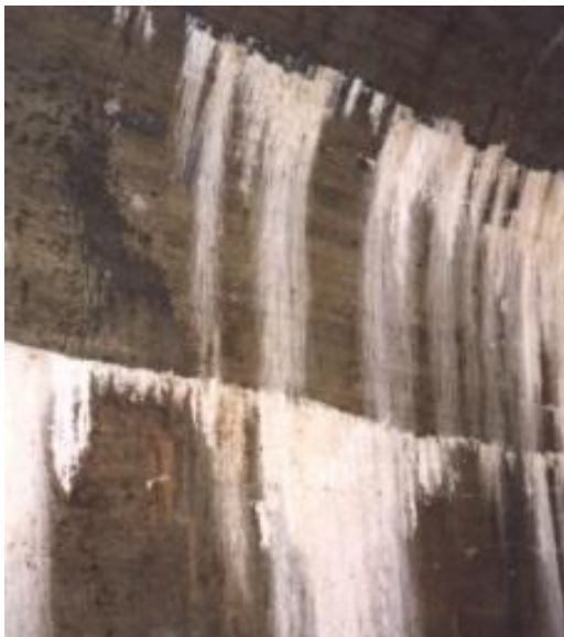
Figura 4.15. Filtraciones entre tongadas (cortesía de Iberdrola)
