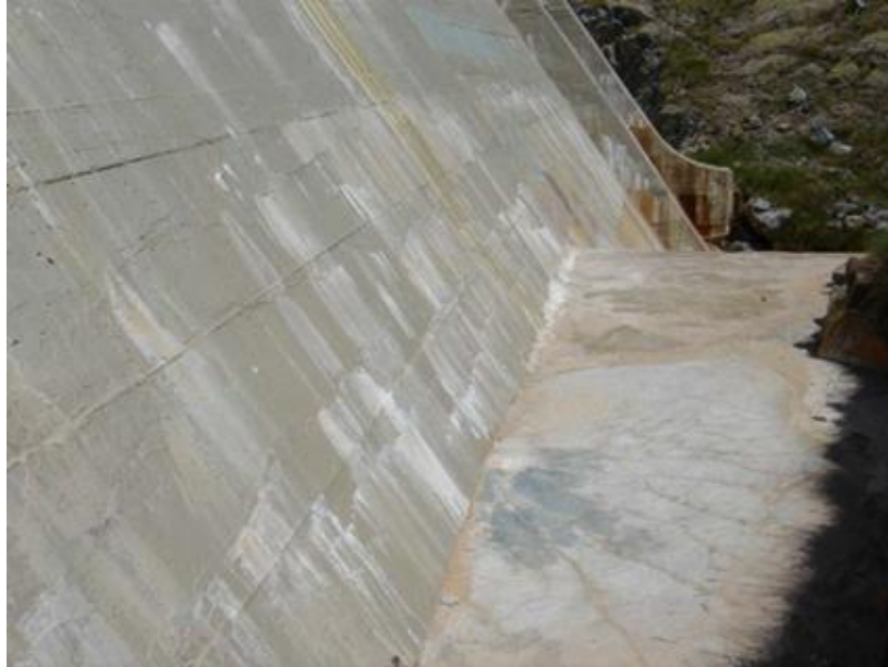
Figura 4.4. Fisuración ramificada con productos de RAS y depósitos de carbonato cálcico (cortesía UPC)
