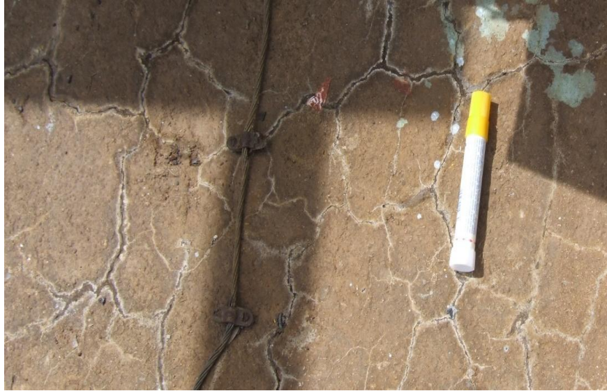
Figura 4.10. Exudación de geles en superficie de hormigón inhibiendo la colonización biológica (cortesía UPC)
