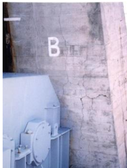
Figura 4.28. Fisuración en una estructura auxiliar de compuerta (cortesía de Iberdrola)
