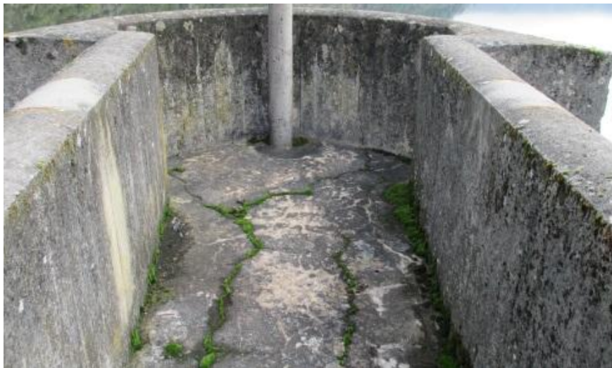
Figura 4.3. Fisuración ramificada en coronación (cortesía de Iberdrola)
