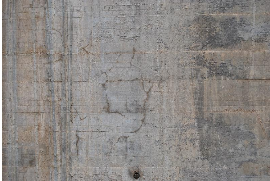
Figura 4.6. Exudación de geles anaranjada debido a la presencia de hierro en los áridos (cortesía IETcc)
