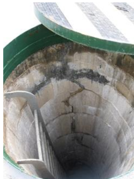
Figura 4.20. Fisuración en un pozo (cortesía de Iberdrola)
