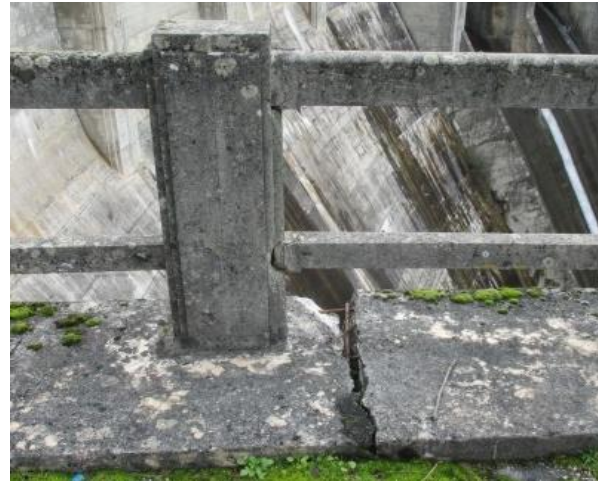
Figura 4.22. Rotura de hormigón en coronación (cortesía de Iberdrola)
