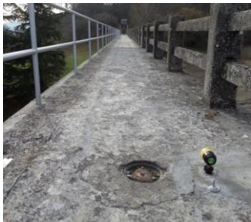
Figura 4.54. Prisma en coronación de presa (cortesía de Iberdrola)
