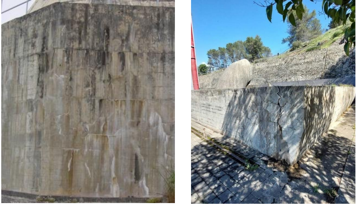
Figuras 4.40 y 4.41. Fisuración en estructuras anejas (cortesía de Iberdrola)
