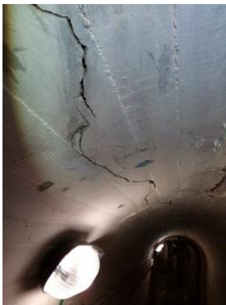
Figura 4.19. Fisura en la clave de una galería (cortesía de A. Aguado)
