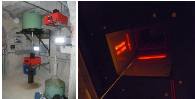
Figura 4.65. Ejemplo de péndulo óptico combinado: camarín con depósitos (izquierda) y sensores ópticos (derecha), (cortesía de Iberdrola)
