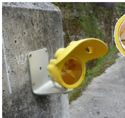
Prisma para monitoreo GPR-112
