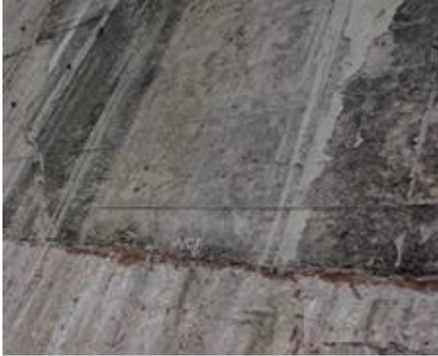
Figura 4.14. Pérdida de material en el paramento de aguas abajo (cortesía de Iberdrola)
