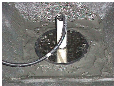
Figura 7.11. Tensímetro instalado en presa (cortesía de Iberdrola)
