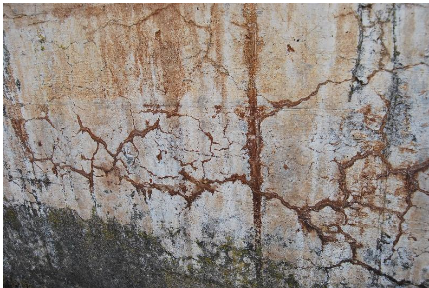
Figura 4.7. Exudación de geles anaranjada debido a la presencia de hierro en los áridos (cortesía de E. Menéndez)
