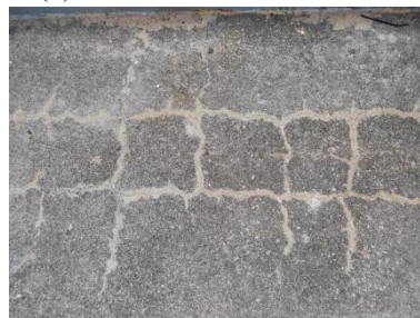
(q) Puente con corrosión 2019
