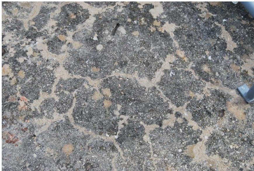
Figura 4.9. Exudación de geles en superficie de hormigón inhibiendo la colonización biológica (cortesía de Iberdrola y E. Menéndez)
