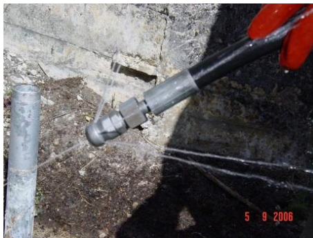
Figura 7.24a. Tobera con agua (cortesía de Iberdrola)
