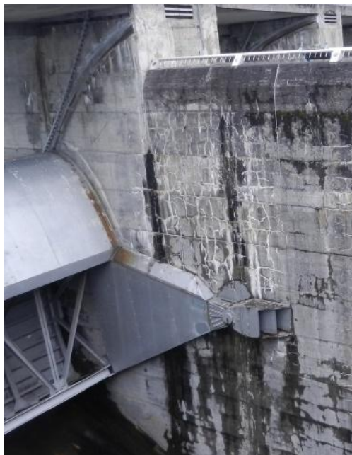
Figura 4.27. Fisuración en la pila del aliviadero con compuerta (cortesía de E. Menéndez)
