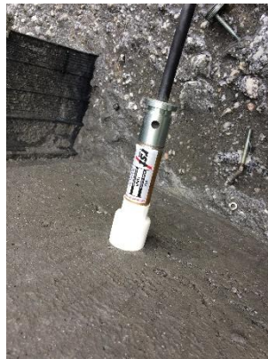
Figuras 7.10 a. Instalación de un dilatómetro de resistencia eléctrica (cortesía de Iberdrola)
