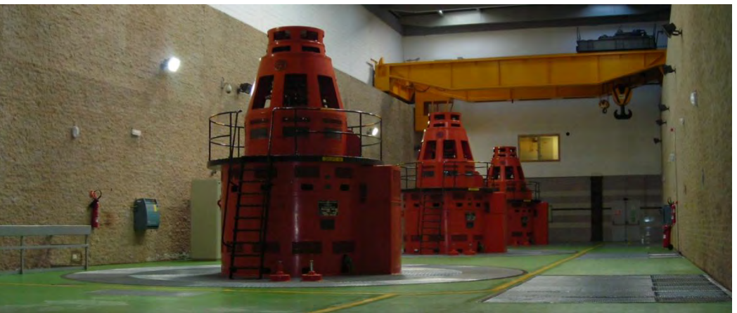
Central Hidroeléctrica de Guillena
