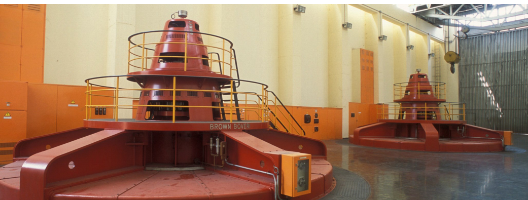
Central Hidroeléctrica de Cornatel
