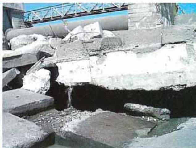
Fig. 1. Vista de la presa de Biciuresti desde aguas abajo, tras el accidente sufrido. Analizado por Stematlu et al. en la R10.
