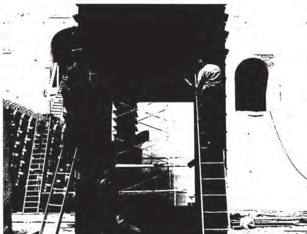
Figura 8. Compuerta Bureau en obra.
