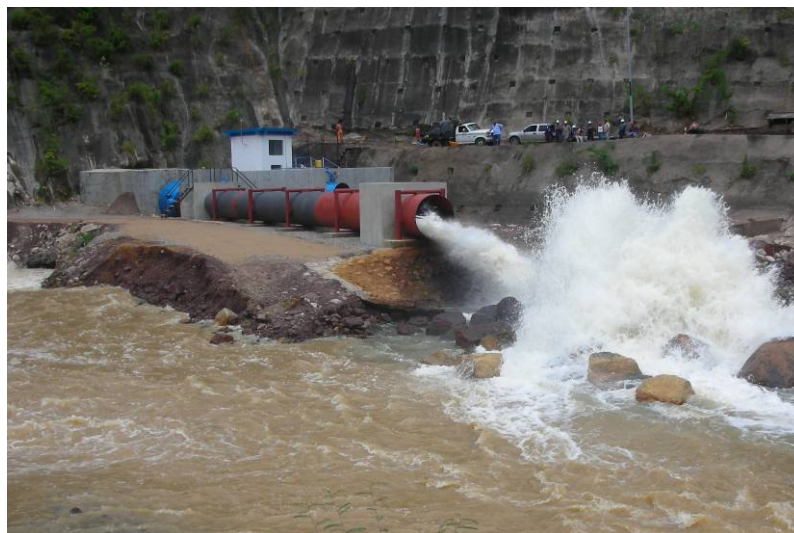
Figura 5.9. Estado actual de la descarga de emergencia.
