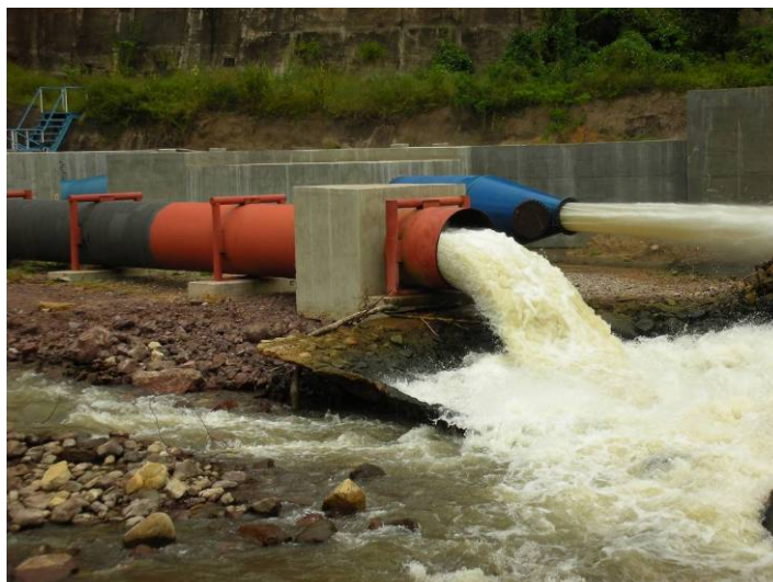
Figura 5.20. Descarga de Emergencia y Adicional.
