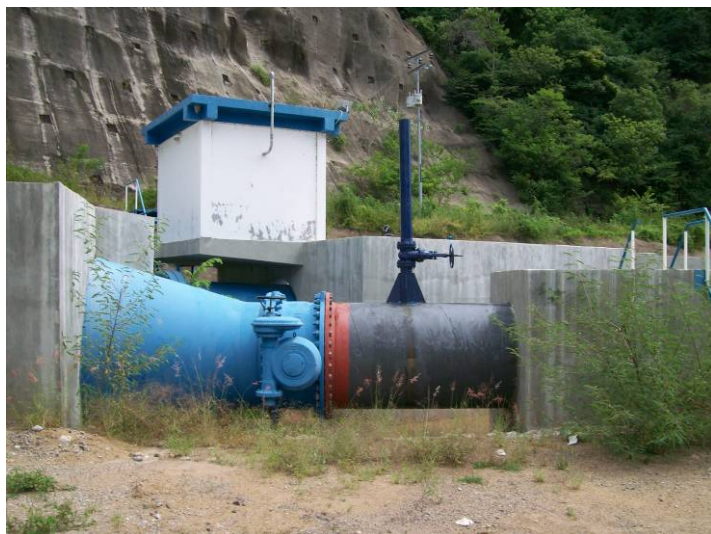
Figura 5.23. Descarga de emergencia
