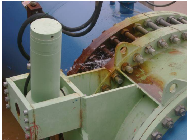
Figura 5.25. Fuga en la válvula de regulación
