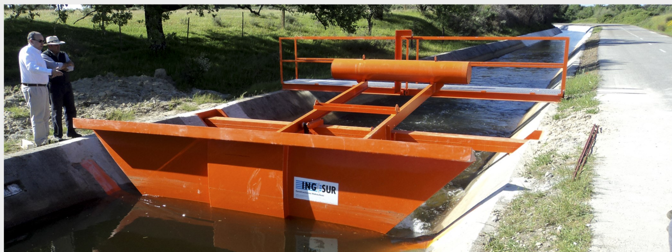
Compuerta de nivel constante en la margen izquierda de la Zona Regable de Rosarito.
