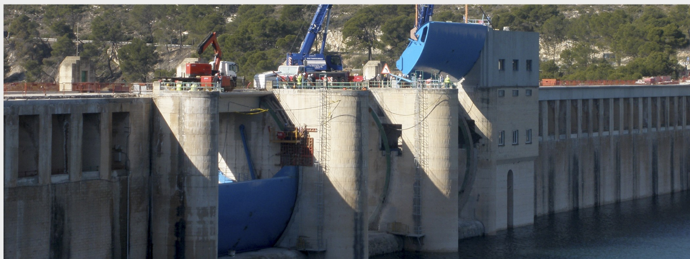
Compuertas Taintor de aliviadero de la presa de Alarcón.
