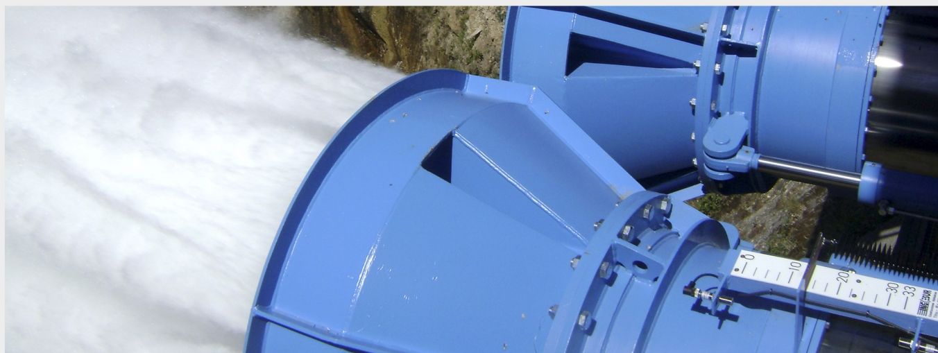
Válvulas Howell-Bunger presa de Fuensanta.
