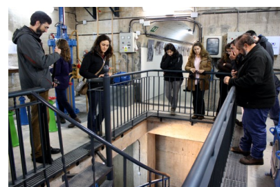
Presa de Aguilar de Campoo. Sala de Válvulas.
