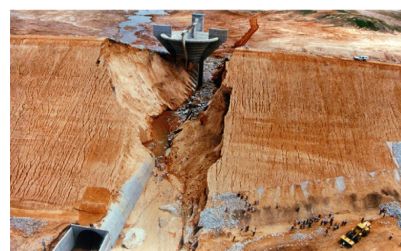
Rotura de la Presa Zoeknag (Sudáfrica)
