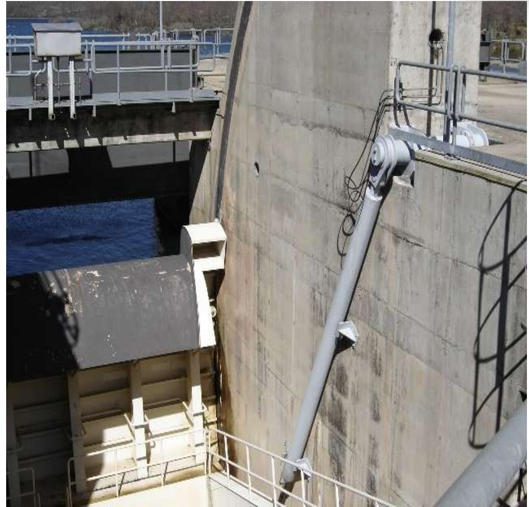
Utilización de aceites biodegradables en accionamientos de presa
