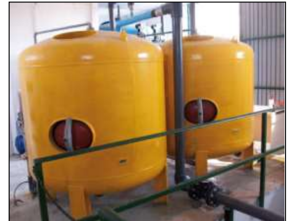
Filtros de arena para control de mejillón cebra
