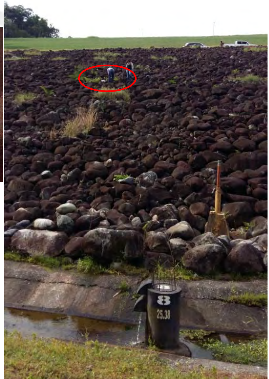
Filtración entre Berma 25 y Berma 42 y pozo de alivio en pie
