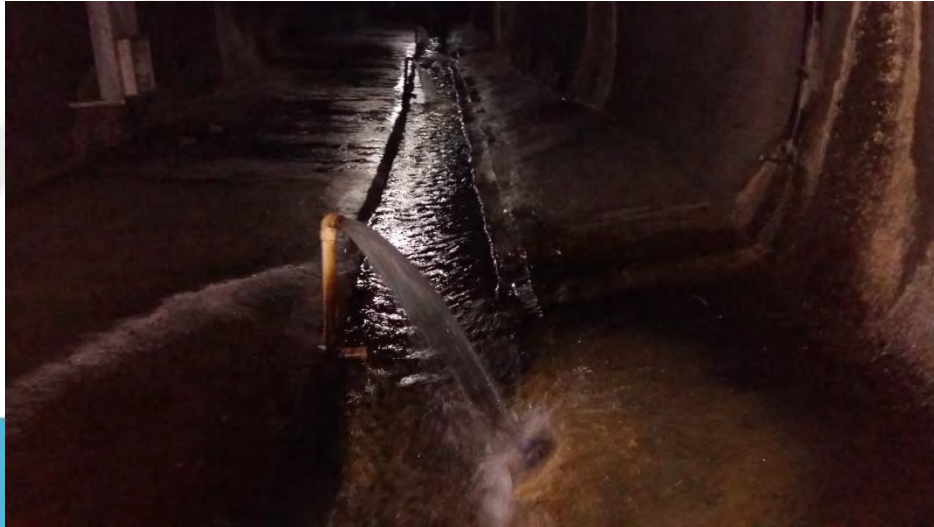
Filtraciones en drenes verticales de la galería gunitada del estribo derecho
