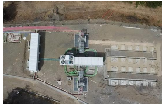
Emplazamiento Batería + Arrancador
